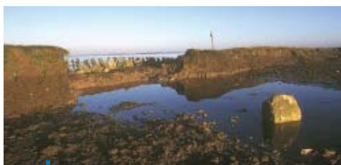
Brèche dans la digue à la mer de la Réserve Naturelle de Moëze (Photo : CEL).
