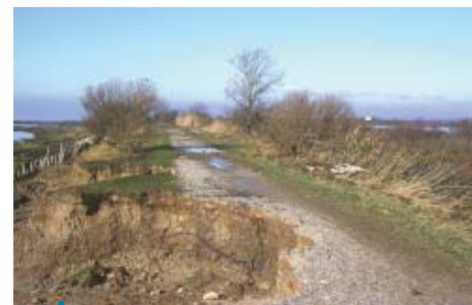
Chemin abîmé sur le domaine de Certes (Bassin d'Arcachon - Photo : CEL).
